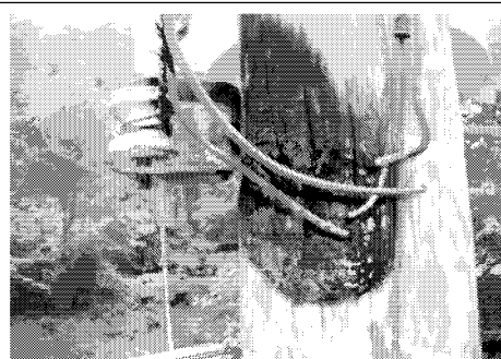
Dommages causés à un poteau téléphonique par un vol de cuivre
